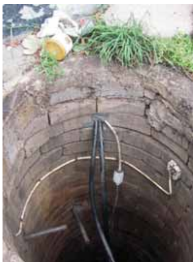
Figur 4-4 Eksempel på uacceptabel brøndkonstruktion
