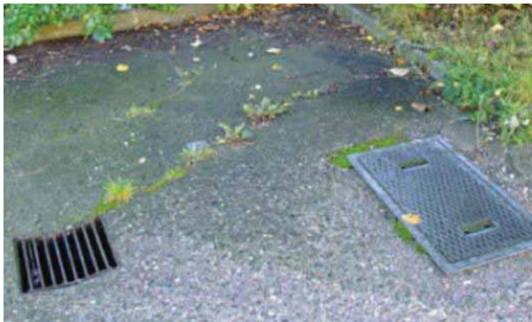
Figur 4-7 Eksempel på belægning ved vejbrønd, der ikke er tæt
